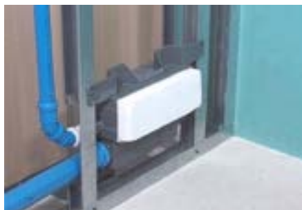
Aplicação em calha técnica
